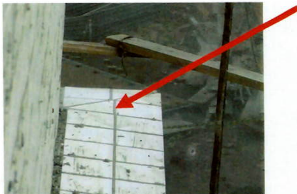
Foto 24: Não assentar sobre superfície mal preparada
