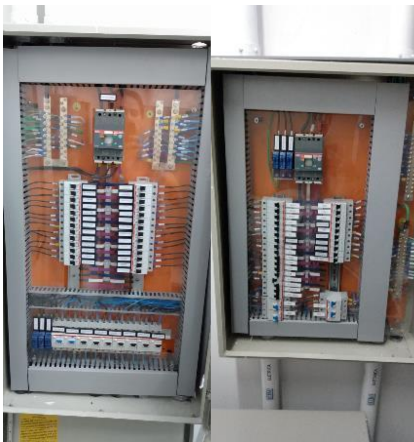
Figura 59 - Quadros de distribuição da obra B.
