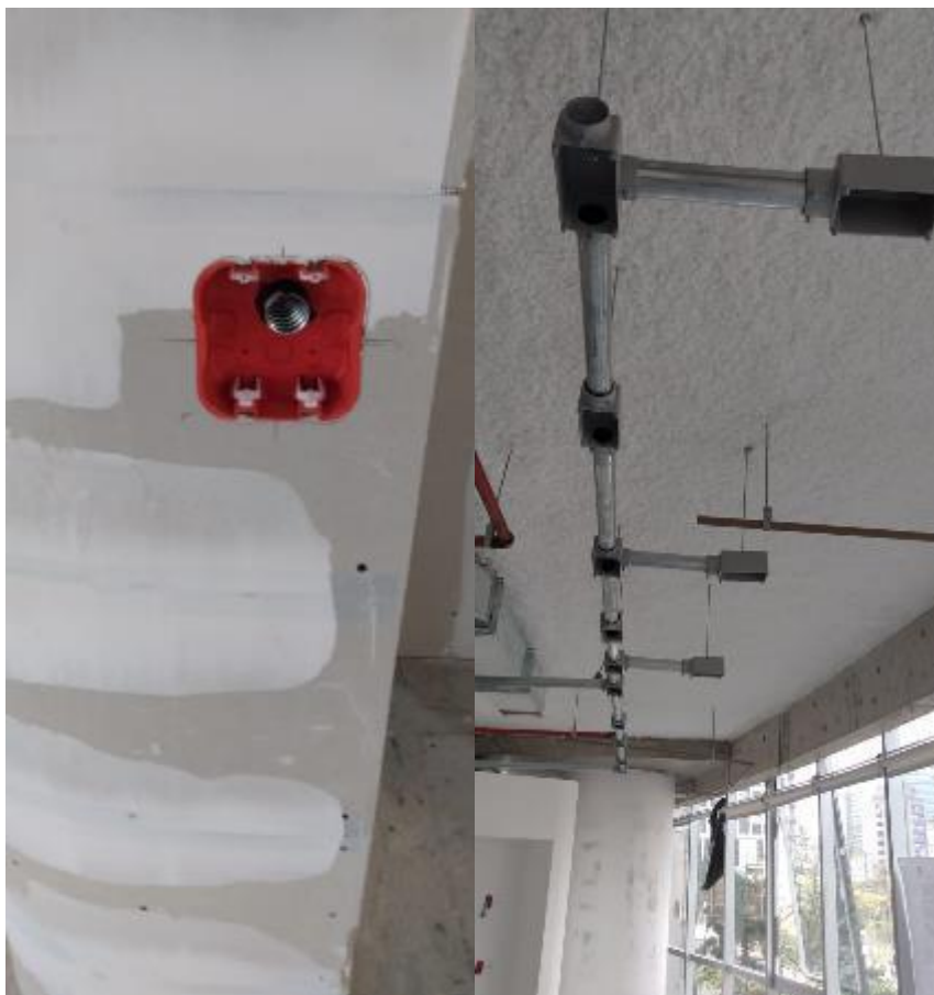
Figura 5 – Fotos de Caixas de derivação embutidos em parede de drywall e Caixas aparente no teto;
