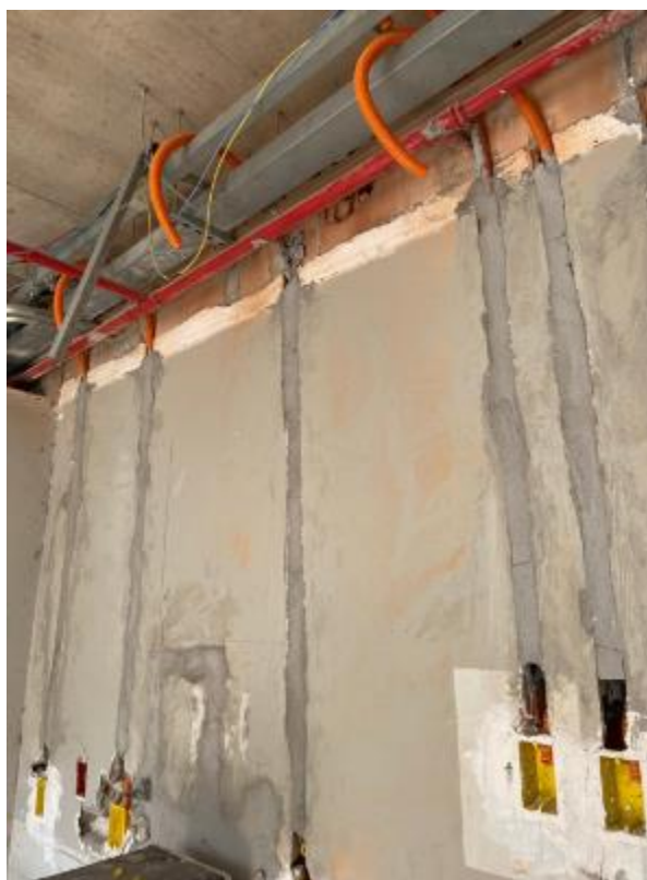
Figura 34 - Foto de Infraestrutura elétrica em parede de alvenaria.
