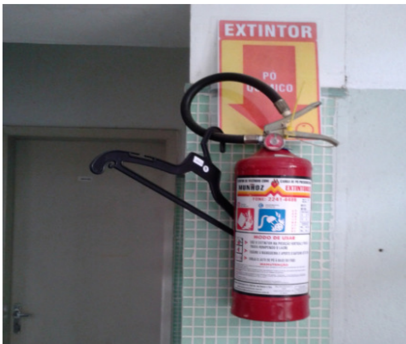
Figura 35 - Extintor com Obstáculos
