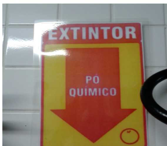
Figura 33 - Sinalização de equipamentos
