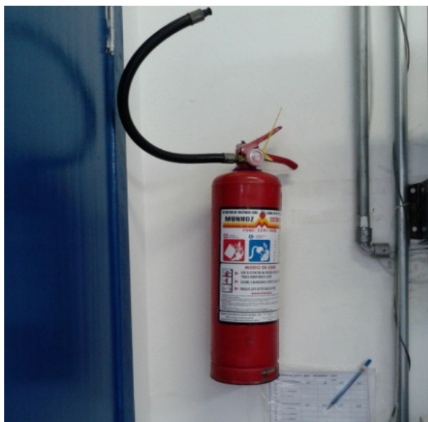
Figura 34 - Extintor sem sinalização
