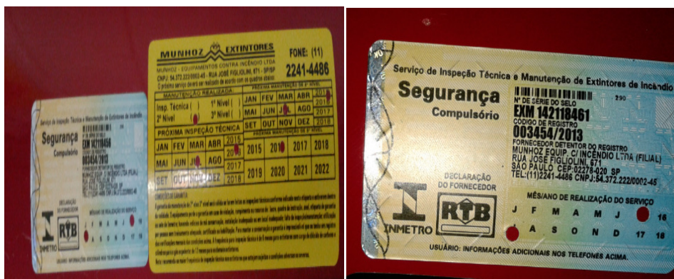
Figura 36 - Identificação e certificado de Extintores
