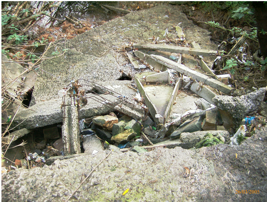
Figura 35. Estrutura que segura a chegada das águas da drenagem rompida na região da nascente do Córrego Santa Fé.
