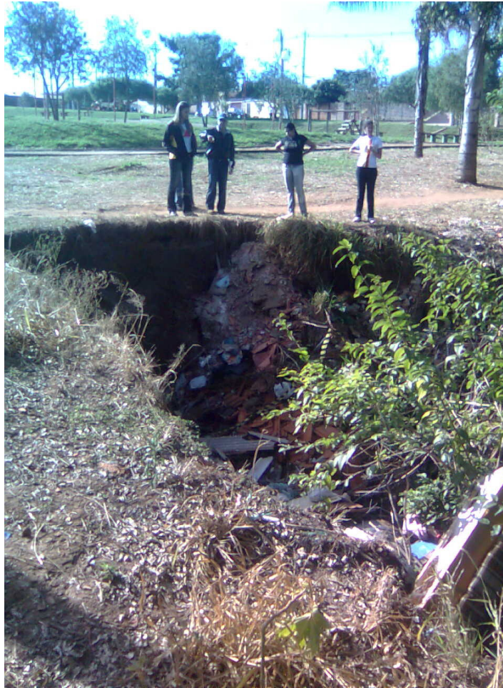
Figura 13. Voçoroca presente bem no ponto de brotamento da nascente principal com presença de resíduos, como entulhos e móveis inutilizados.
