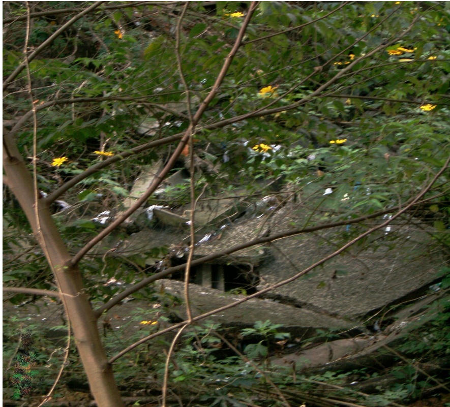
Figura 23. Sistema de drenagem pluvial rompido na APP da nascente do córrego Santa Fé.
