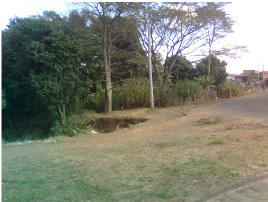
Figura 14. Localização da voçoroca presente na nascente principal perto da rua e também das residências pondo em risco as pessoas que vivem por essa área.
