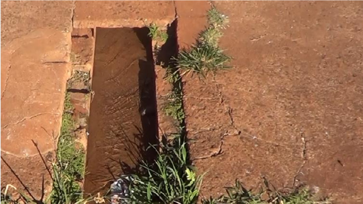
Figura 6 – Vazamento na calçada da estação elevatória Vila Augusta
