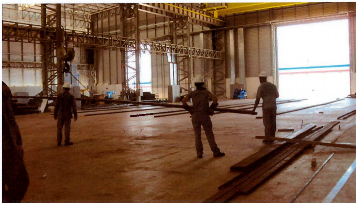
Figura 35 – Utilização da ponte rolante para a movimentação de peças que serão soldadas Fonte: Lima, 2010
