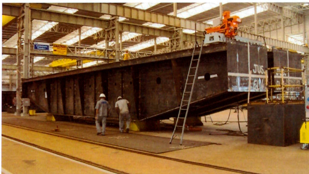
Figura 33 – Montagem da comporta em posição vertical, não tem facilidade de acesso interno, é necessário uso de escadas e aumenta risco de queda Fonte: Lima, 2010
