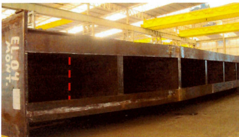
Figura 32 – Montagem da comporta em posição horizontal facilidade o acesso interno evitando uso de escadas e diminuindo risco de queda, soldagem em local demarcado Fonte: Lima, 2010
