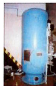
Figura 4 - Tanque de gás Fonte: JML equipamentos e projetos Ltda
