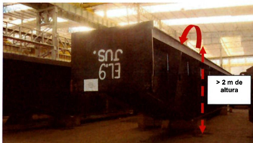
Figura 18 – Soldagem interna da comporta, soldador em exposição a ambientes semiconfinados e acesso interno por escada interna e externa, dificuldade de acesso. Fonte: Lima, 2010
