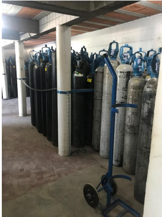
Figura 18 – Armazenamento de cilindros sem corrente de fixação.
