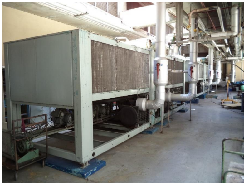
Figura 4-4: Chillers da CAG Hotel Fonte: Cortesia da Administração do Hotel
