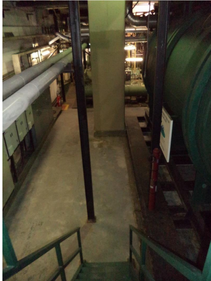
Figura 4-3: Tanque de Termoacumulação da CAG Business Tower Fonte: Foto tirada pelo próprio autor
