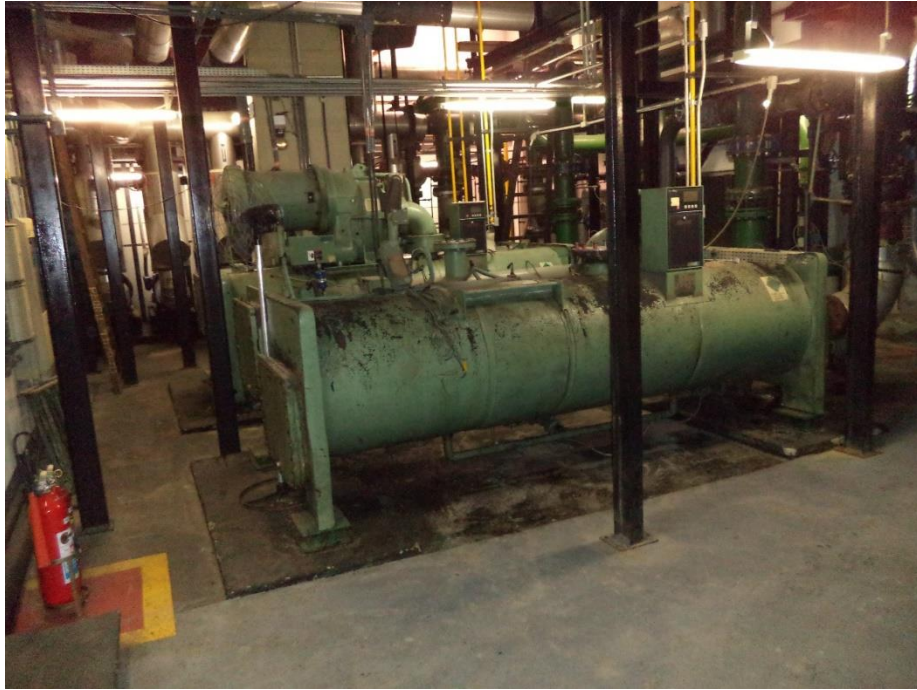
Figura 4-2: Fotografia dos Chillers originais da CAG da Business Tower Fonte: Foto tirada pelo próprio autor
