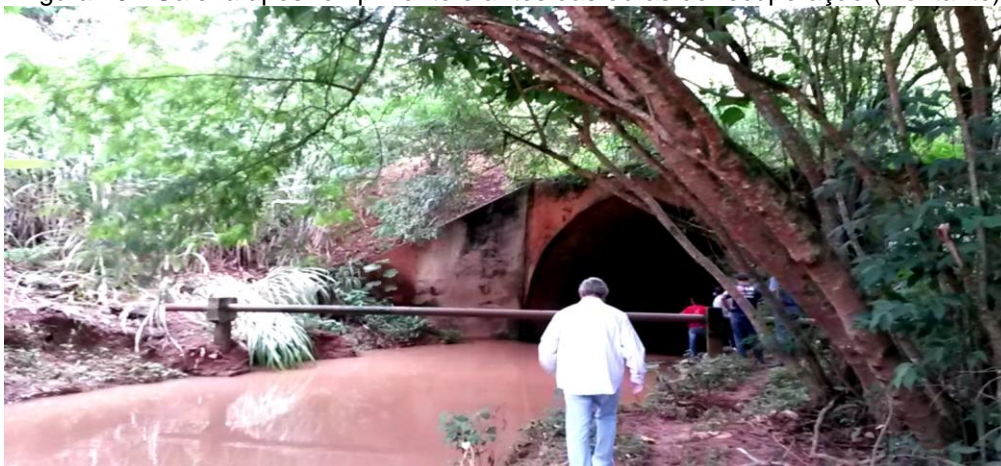
Figura 70 - Galeria após rompimento e antes das obras de recuperação (montante)
