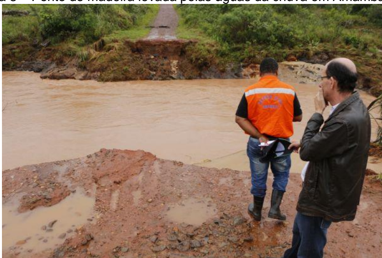
Figura 3 – Ponte de madeira levada pelas águas da chuva em Amambaí - MS
