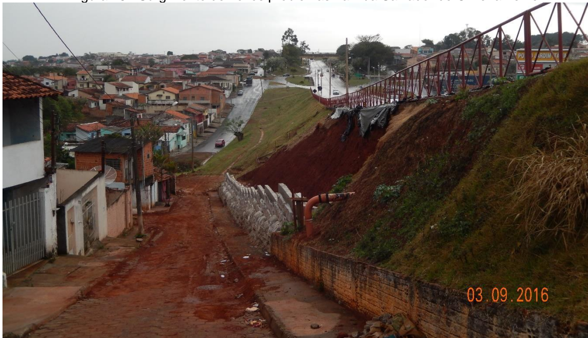
Figura 76 - Surgimento de novos problemas na Rua Salvador de Oliveira Leme
