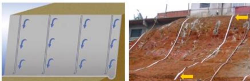
Figura 29 – Esquema representativo (à esquerda) e exemplo de utilização numa obra (à direita) de dreno linear contínuo
