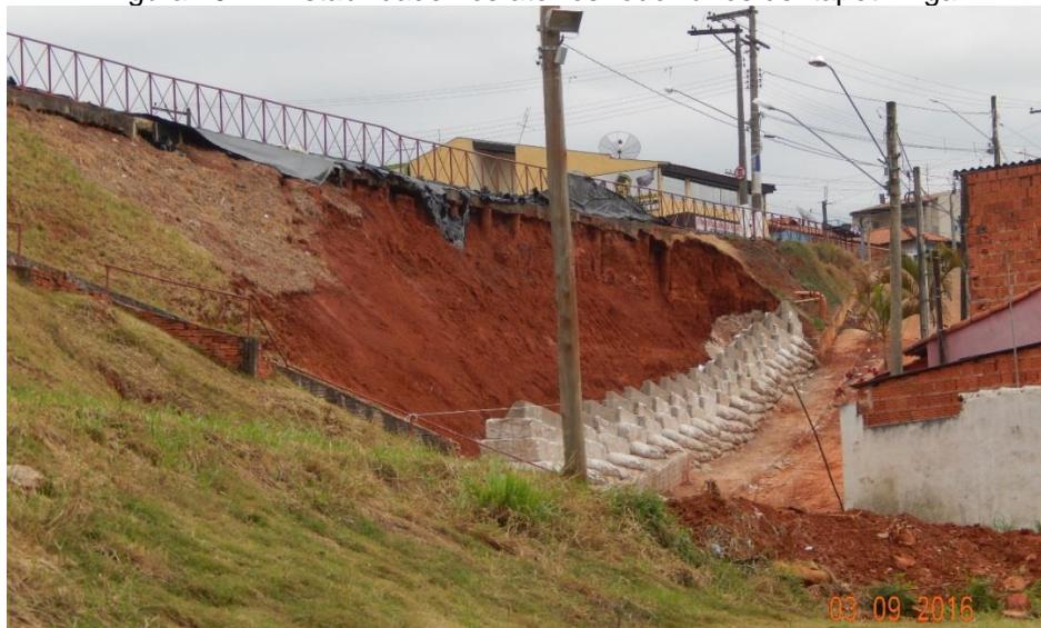
Figura 104 – Instabilidade nos aterros rodoviários de Itapetininga
