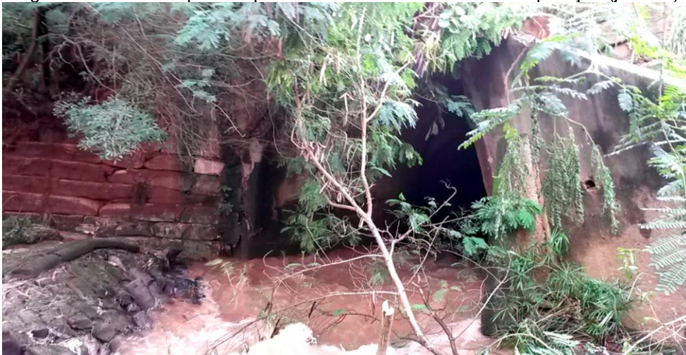
Figura 69 – Galeria após rompimento e antes das obras de recuperação (jusante)
