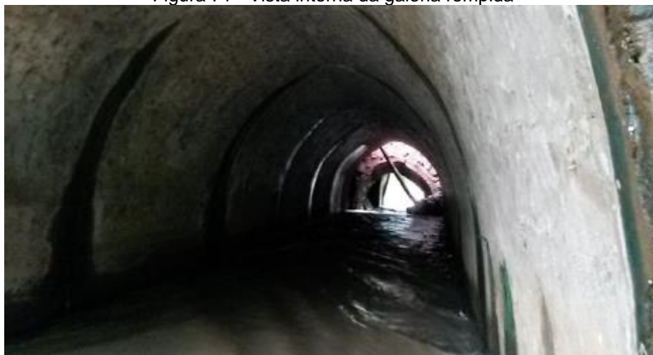
Figura 71 - Vista interna da galeria rompida
