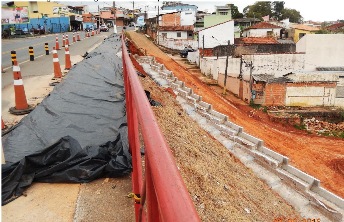
Figura 75 – Surgimento de novos problemas na Rua Salvador de Oliveira Leme
