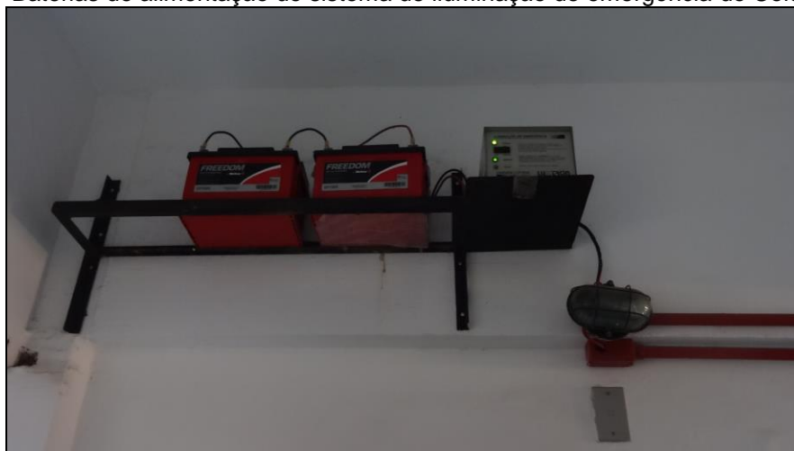
Figura 6 – Baterias de alimentação do sistema de iluminação de emergência do Colégio Escola
