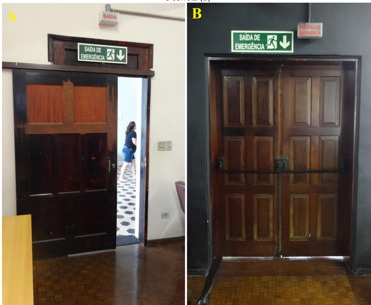
Figura 14 – Portas de saída de emergência de uma mesma sala, projetadas de maneiras incorreta (A) e correta (B)
