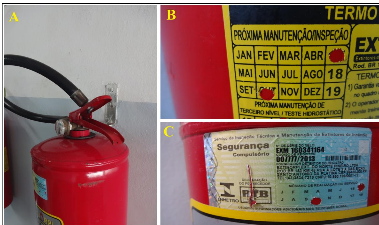
Figura 5 – Desconformidades encontradas em extintores: ausência de lacre (A) e validade de manutenção expirada (B e C)
