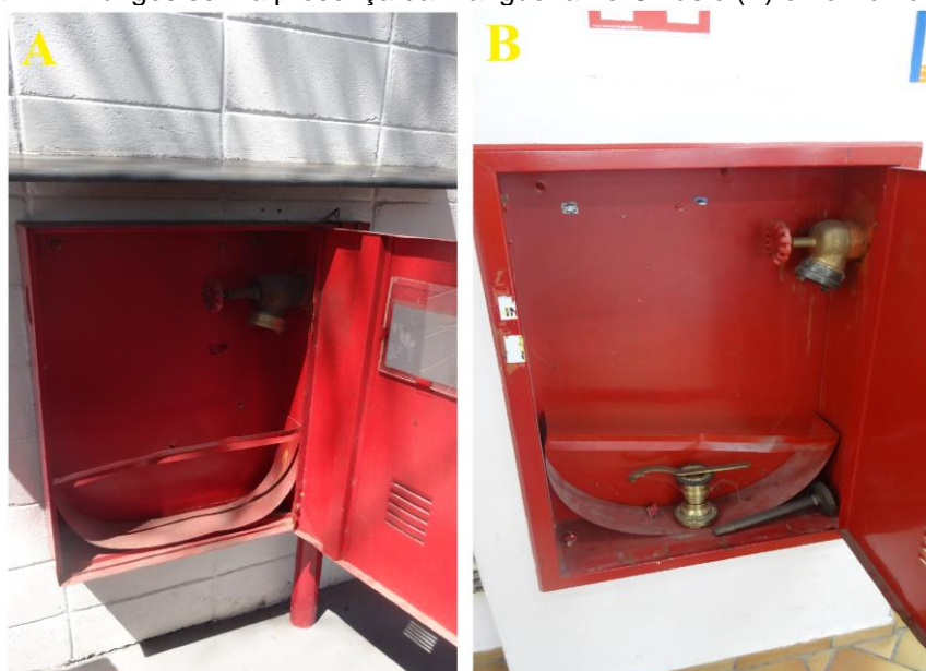
Figura 12 – Abrigos sem a presença da mangueira no Ginásio (A) e no Edifício C (B)
