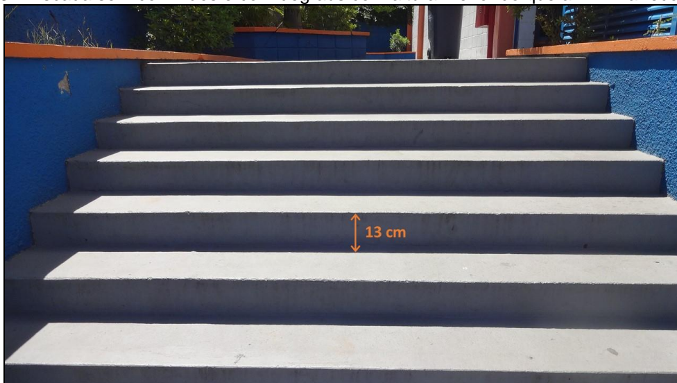
Figura 13 – Escada sem corrimãos e com degraus com altura menor do que a mínima recomendada
