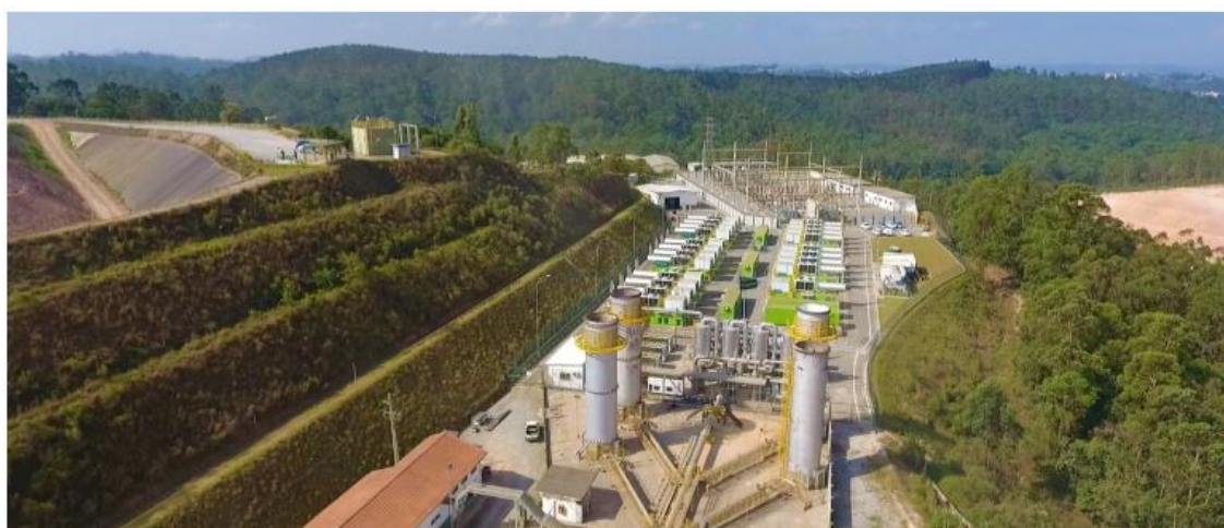
Figura 3.2 - Usina Termelétrica na CVTA Caieiras.
