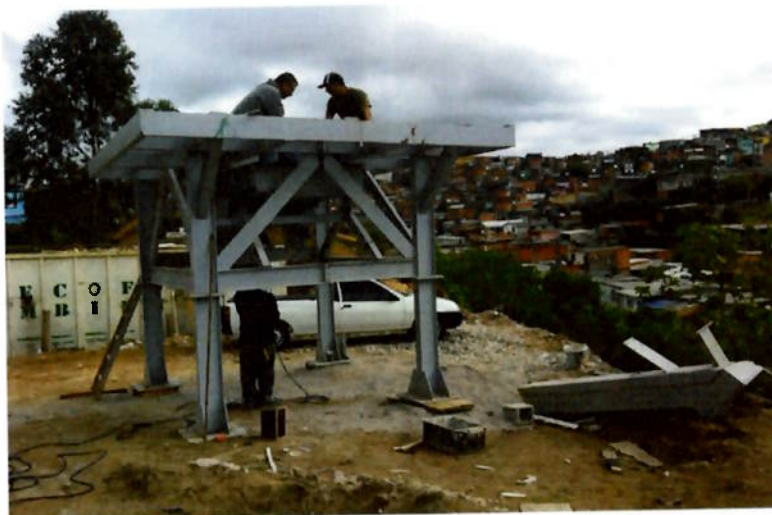
Figura 4 – Instalação de peneira de alta-frequência para fracionamento da areia para aplicação em argamassas. Fonte: ATT Morelix
