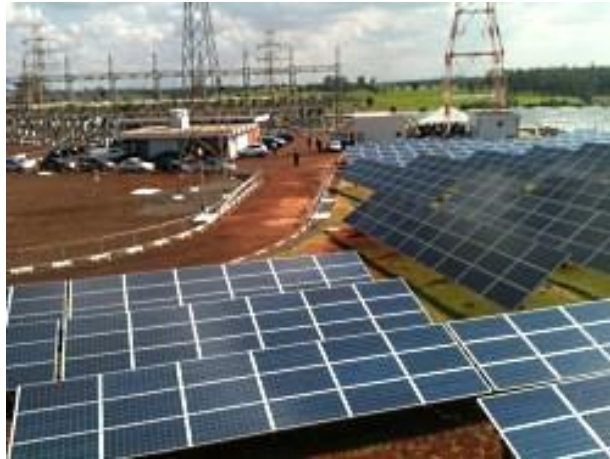
Figura 4 - Usina Solar Tanquinho - Campinas/SP [16]
