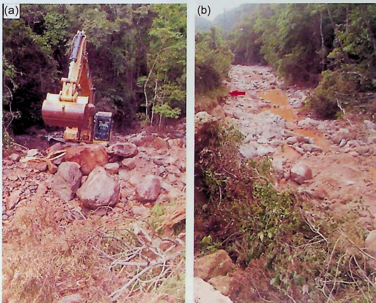
Figura 24 – (a): Curva do Rio Paúba onde o material mobilizado pela corrida de detritos rompeu o leito e invadiu a Rua Belo Horizonte. (b): Início do depósito da corrida de detritos logo após o rompimento do leito do rio, é possível ver as árvores derrubadas no processo e a erosão do nível da rua (seta vermelha).
