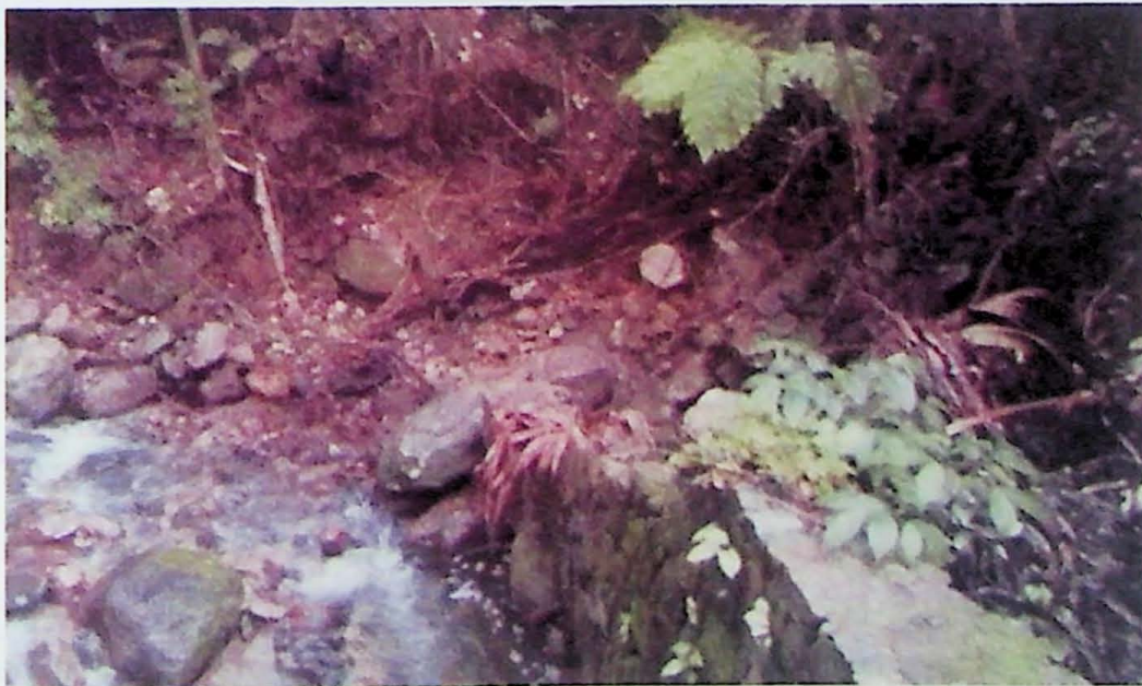
Figura 28 – Muro parcialmente danificado pela corrida de detritos próximo a uma leve curva da drenagem (o muro tem aproximadamente 2 metros de altura).
