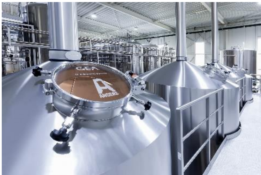
Figura 3.19: Sala com tina de mostura com aquecimento direto.
