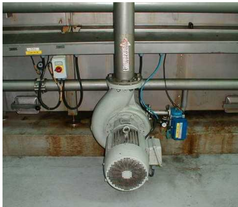
Figura 3.25: Bomba de recirculação de água do pasteurizador.
