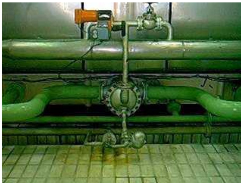
Figura 3.24: Trocador de calor de pasteurizador.
