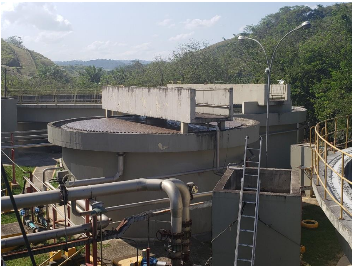
Figura 4.7: Adensador de lodo
