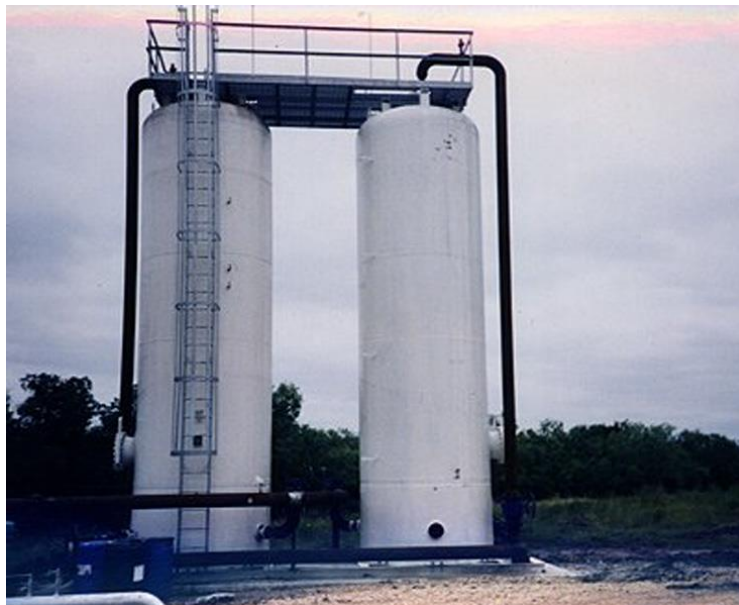
Figura 6.5: Vaso para instalação do Sulfatreat®.
