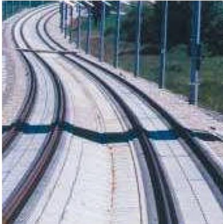
Figura 35 – Via em Laje da Bögl em Nurembergue – Ingolstadt NBS Fonte: Relatório Halcrow/Sinergia – Vol. 4
