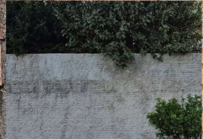
(↑) Marcas pretas da altura antiga do muro da fachada.
