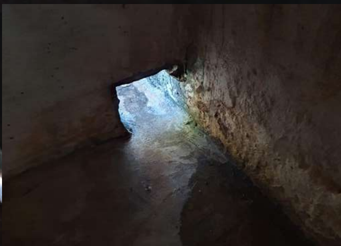
(↑) Buraco deixado na base da parede para escoamento da água. Vista interior.
