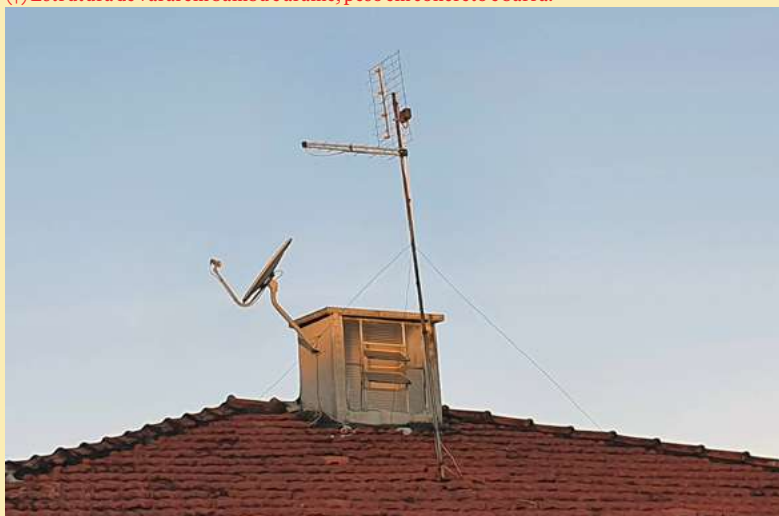
(↑) Respiro no meio do telhado.
