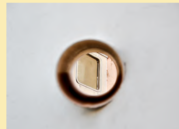
(↑) Cano atravessando o muro permite a visão do relógio de energia.
