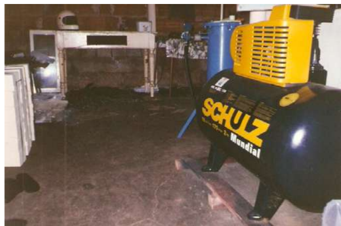
(↑) Máquina compressora de ar.
