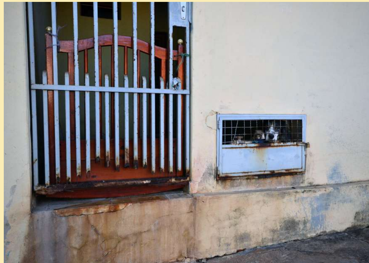
(↑) Gambiarra no portão corroído.
