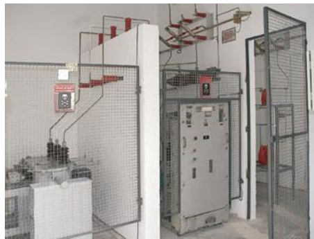
Figura 32 – Subestação de Energia
