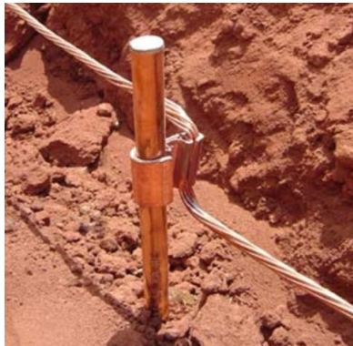
Figura 5 – Subsistema de Aterramento
