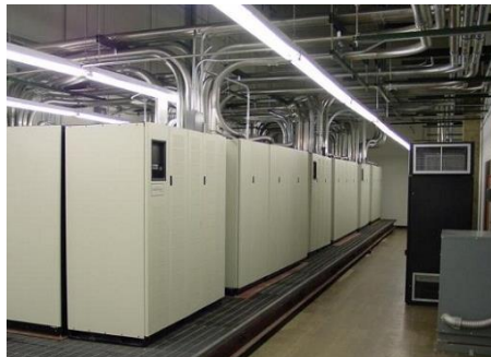
Figura 34 – Sala de Nobreak
