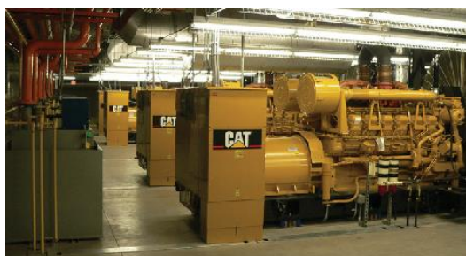
Figura 33 – Grupo Motor Gerador
