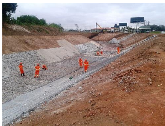
Fig. 10 - Canal de Circunvalação no Parque Ecológico do Tietê, São Paulo/SP, em construção. Fonte: DAEE
