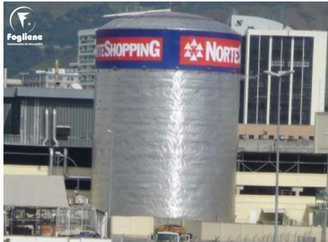
Figura 6 - Tanque com isolamento térmico
