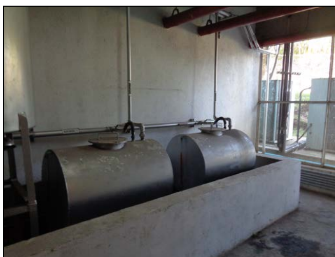
Figura 3 – Exemplo de tanque de horizontal
