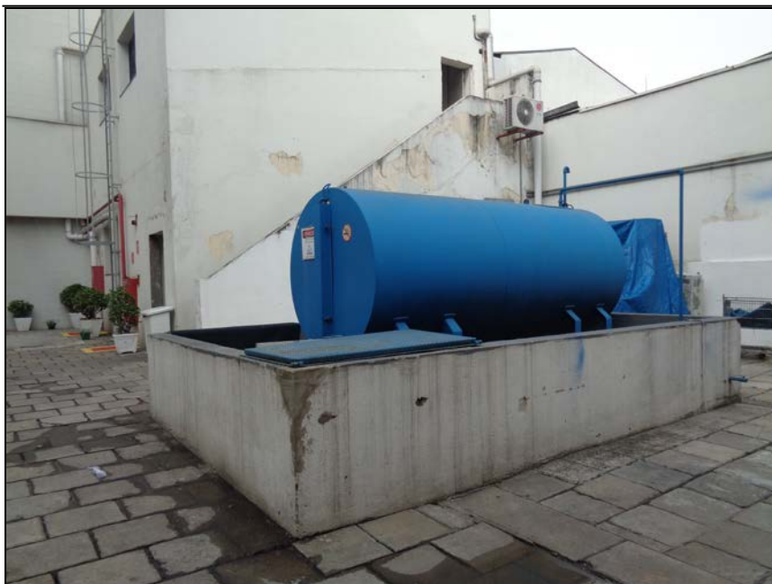
Figura 11 – Exemplo de bacia de contenção
