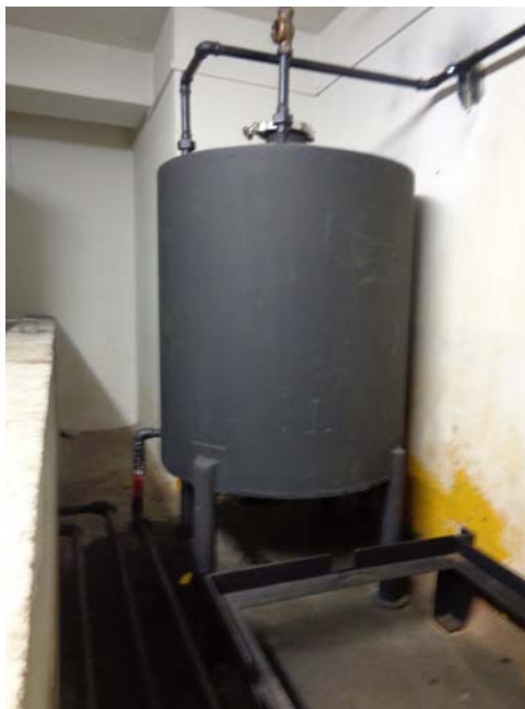
Figura 6 – Exemplo de tanque vertical
