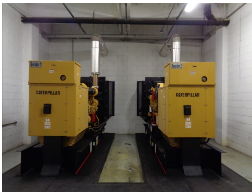
Figura 21 – Geradores do CPD
