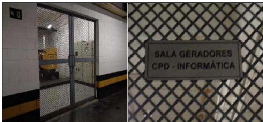
Figura 20 – Sala Geradores CPD
