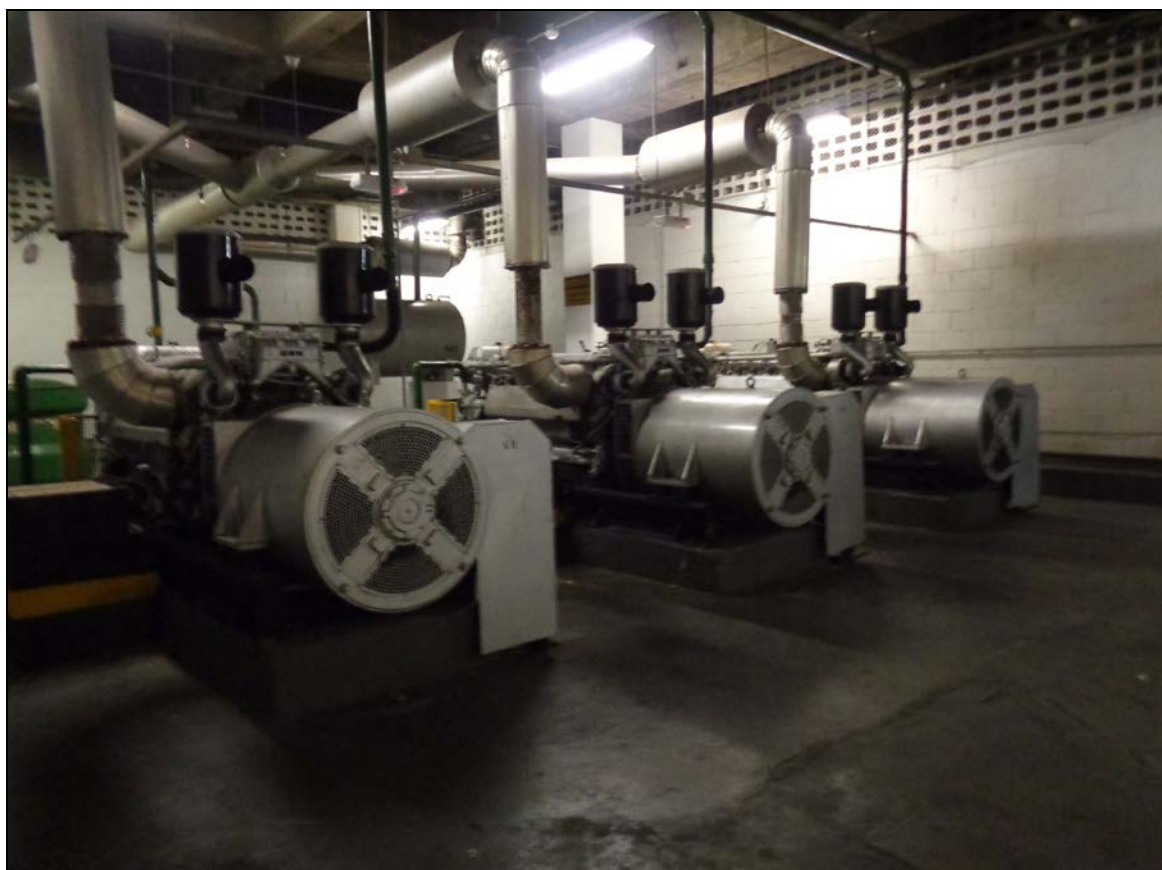
Figura 16 – Sala 1 - Geradores Bodarco
