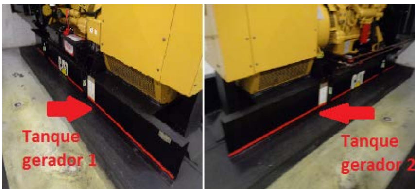
Figura 22 – Tanques de consumo em cada gerador
