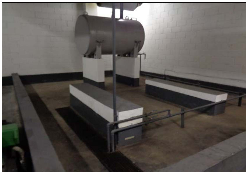
Figura 17 – Tanque de estocagem e consumo de óleo diesel
