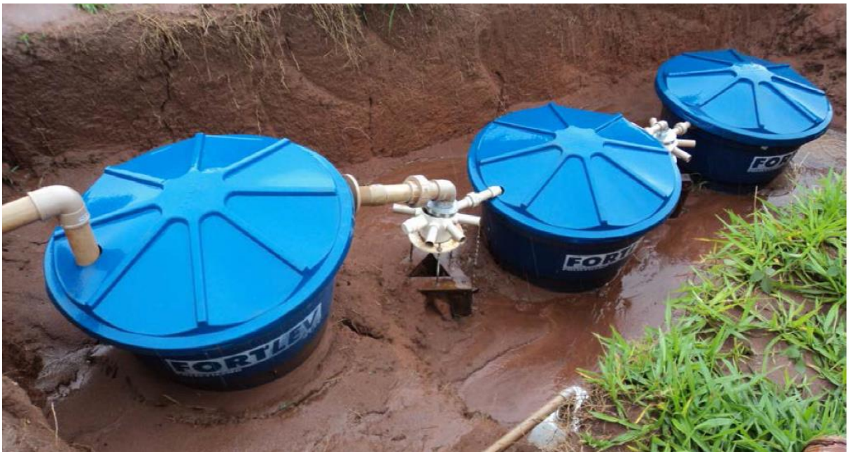
Figura 05. Conjunto de caixas d'água e divisores para armazenamento de escoamento e sedimentos
