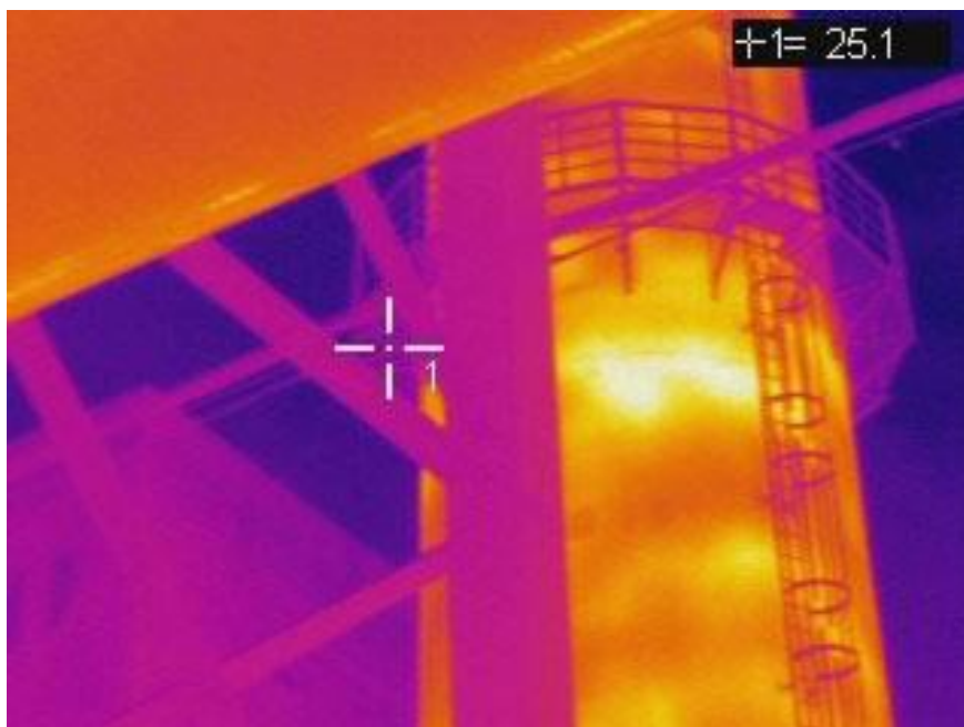
Figura 15 - Imagem captada por câmera térmica em chaminés para identificação de regiões com superaquecimento
