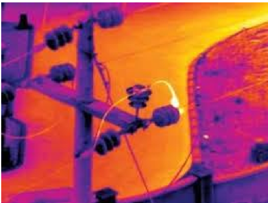
Figura 14 – Imagem captada por câmera térmica em unidade de transmissão de energia
