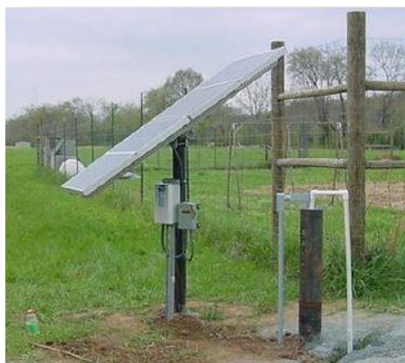
Figura 19: Sistema de bombeamento alimentado por painel fotovoltaico. Fonte: (SOUZA, 2016)
