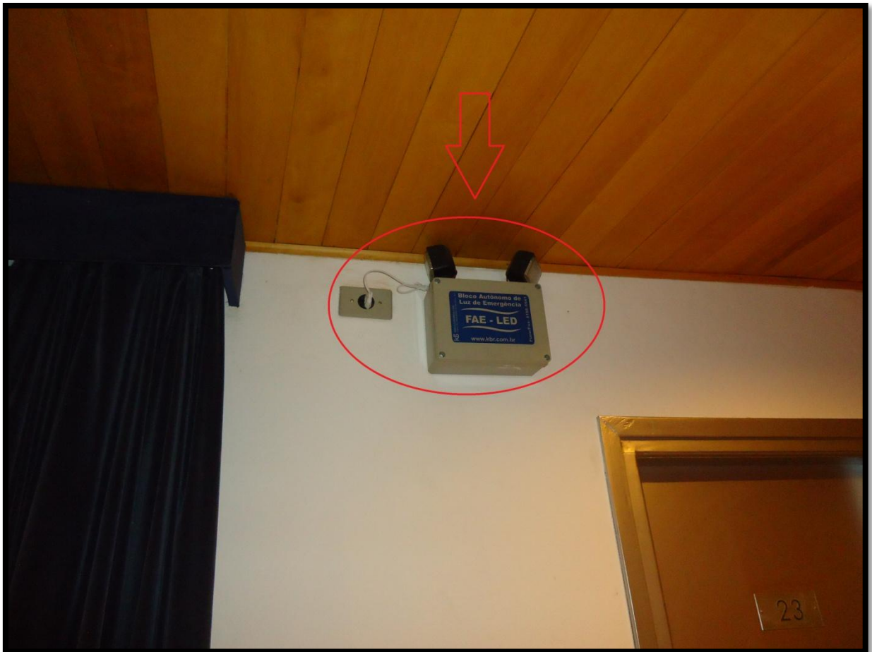
Figura 11: Iluminação de Emergência.
