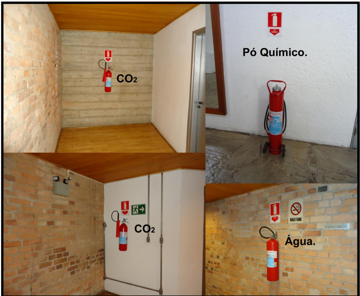
Figura 15: Extintores de Incêndio.
