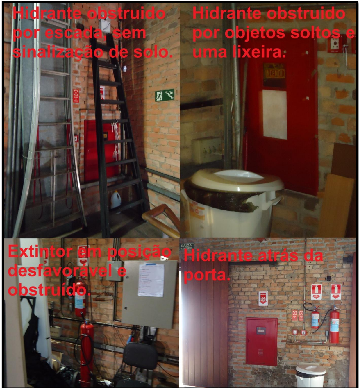
Figura 19: Equipamentos de proteção obstruídos e sem sinalização de solo.
