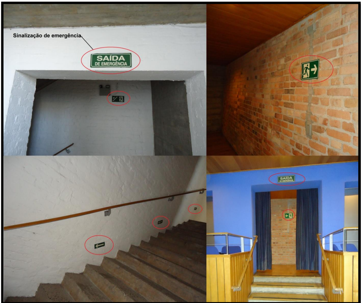
Figura 14: Sinalização de Emergência.
