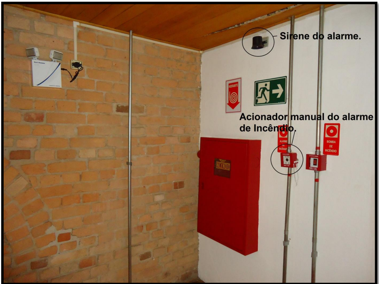
Figura 13: Acionador manual do alarme de Incêndio.
