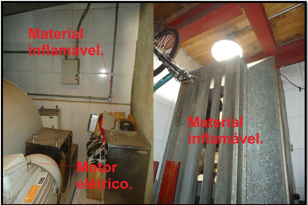
Figura 18: Sala do ventilador.
