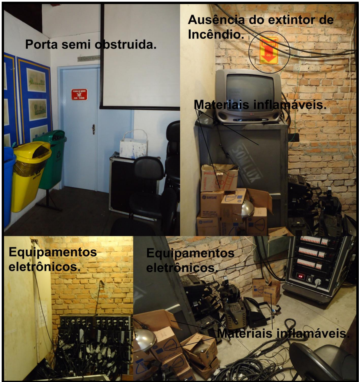
Figura 17: Sala dos quadros de iluminação.
