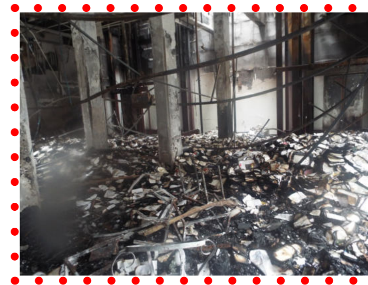
Local onde o incêndio começou.
