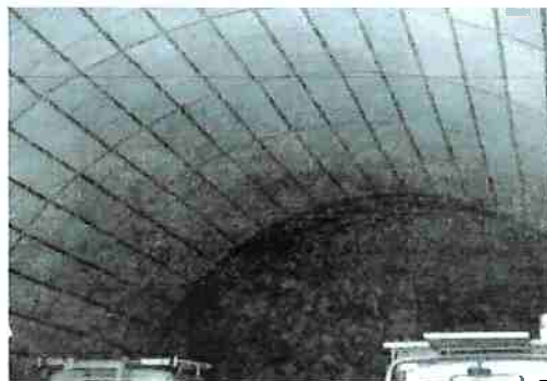
Figura 06 – placas para absorção de som dentro de um túnel (09)
