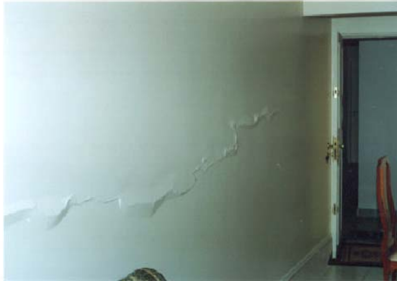
Figura 3.2.1 – Fissuras em alvenaria por deformação vertical da viga
