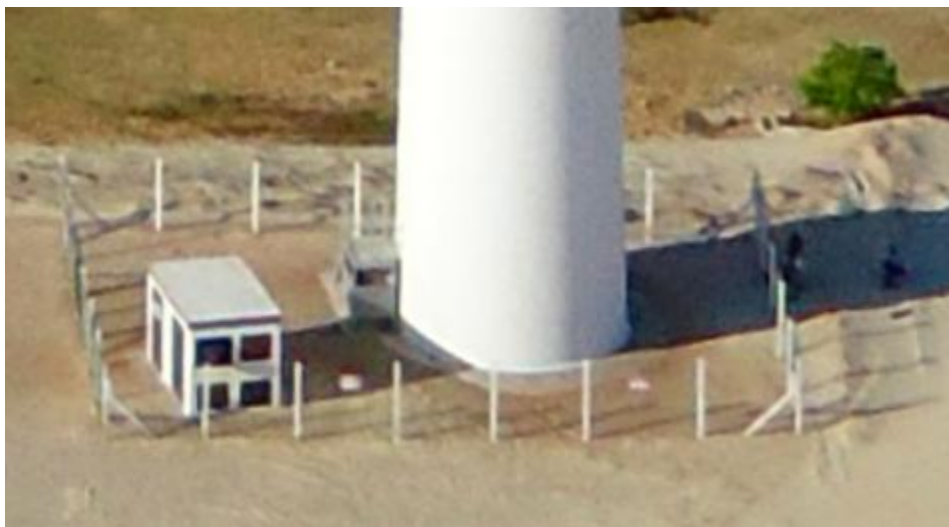
Figura 56: Cerca de proteção e subestação unitária de uma torre em um dos parques em Trairi.
