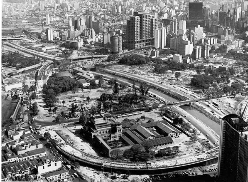
Figura 20 - Parque Dom Pedro II em obras, 1969. Fotografia de Ivo Justino. Fonte: Acervo do Museu da Cidade de São Paulo.
