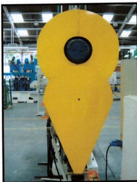
Figura 19 – Proteção das transmissões de força
