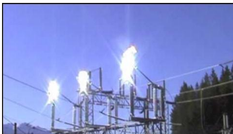
Figura 5 - Arco elétrico em manobra elétrica em Subestação de energia.
