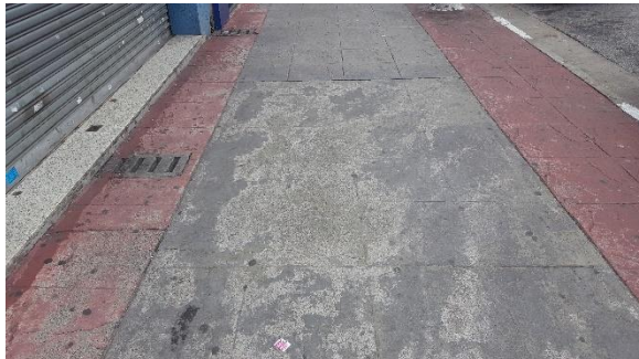
Foto 11 - Piso tátil de travessia e faixas de pedestres falhadas
