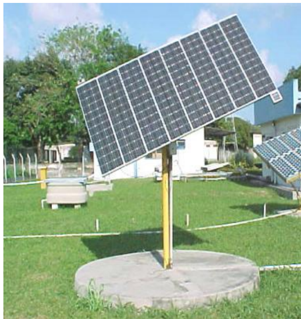
Figura 20 – Painel solar fotovoltaico com rastreador (Fonte: [27])
