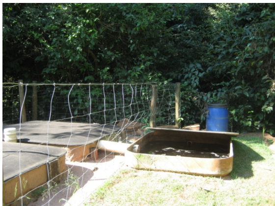
Figura 4 - Caixa de acumulação de esgoto tratado, ponto de coleta do efluente de fossa séptica biodigestora
