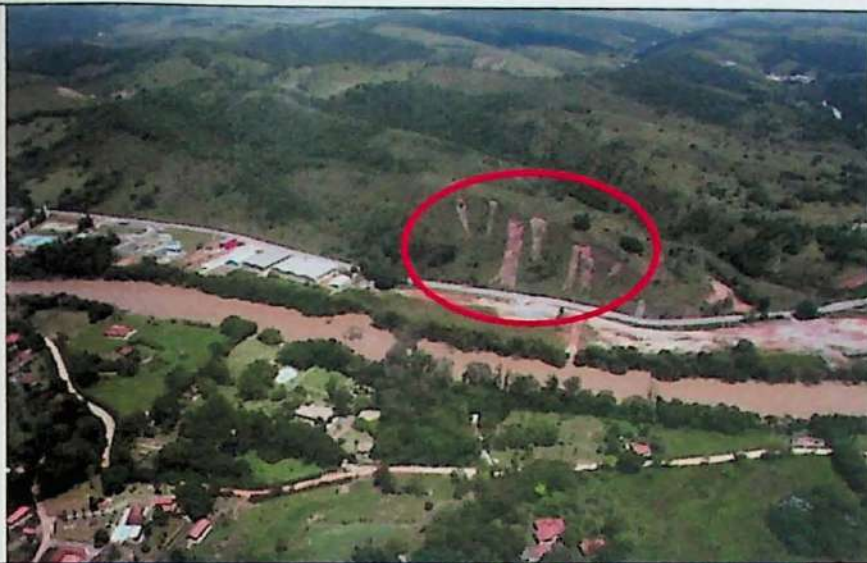
Foto: FH_MG_P1a (Foto de Helicóptero, Município de Guararema, Ponto 1): Vista geral do talude com altura de ~20m, com destaque em vermelho para as cicatrizes de escorregamento tipo planar, ocorridos em janeiro de 2010. Foto: Prefeitura do Município de Guararema
