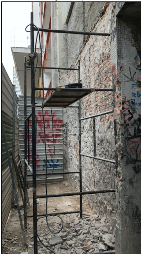
Figura 24 - Andaime irregular – piso em 2 metros de altura
