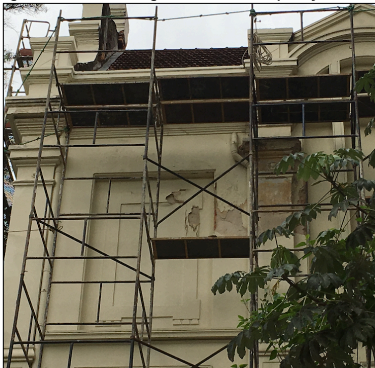
Figura 25 - Andaime irregular – ausência de proteção coletiva
