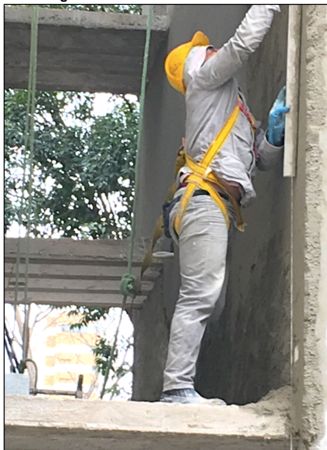
Figura 29 – Uso do talabarte incorreto
