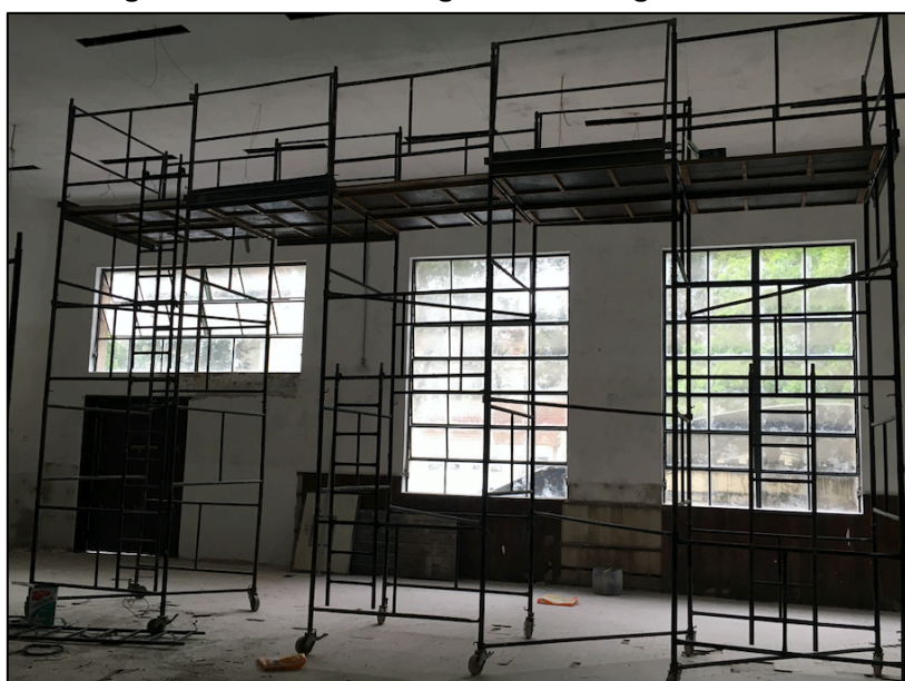
Figura 26 - Andaime irregular – montagem incorreta
