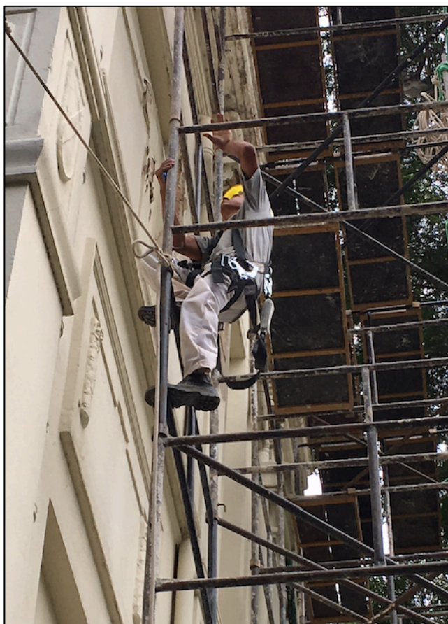
Figura 30 – Trabalhador escalando o andaime sem estar com o EPI conectado
