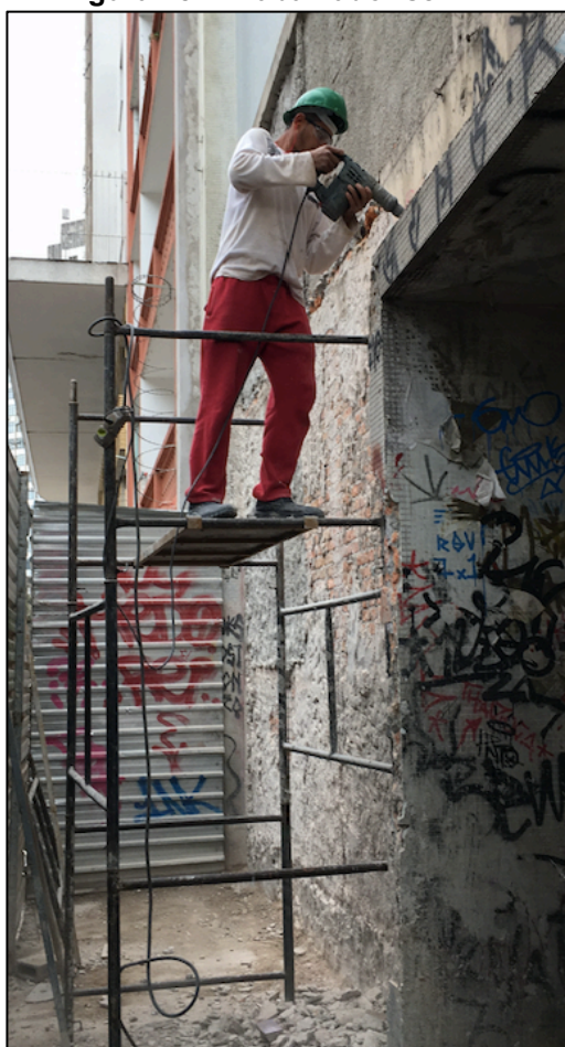
Figura 28 – Trabalhador sem EPI
