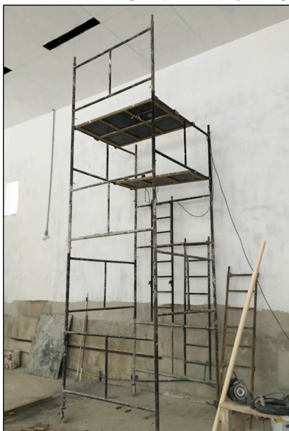
Figura 23 - Andaime irregular para colocação de gesso
