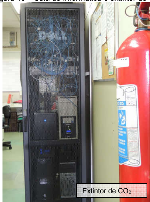
Figura 10 – Sala de Informática e extintor de CO 2
