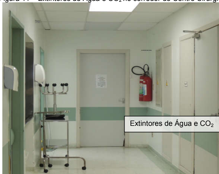
Figura 11 – Extintores de Água e CO 2 no corredor do Centro Cirúrgico
