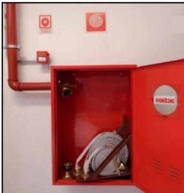
Figura 13 - Detalhe de hidrante
