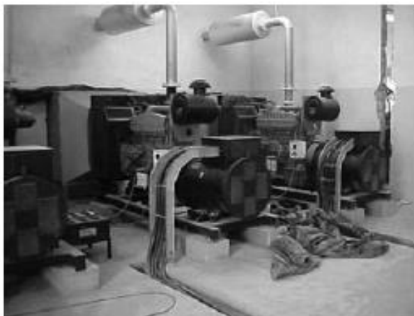
Figura 11 - Grupo Moto gerador
