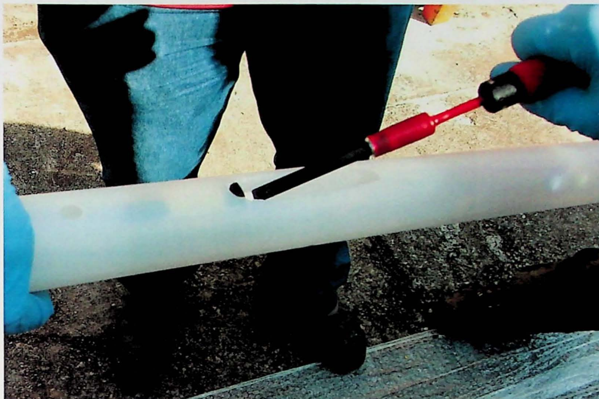
Figura 9 – Selamento do canal, notar o orifício por onde foi introduzido o inserto mecânico e onde será instalada a tela de aço inoxidável.
