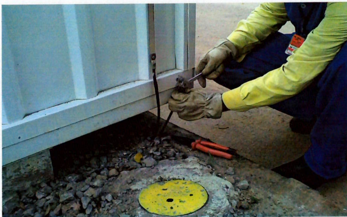
Foto 26. Detalhe da interligação do barramento de descida do pára-raios à haste de aterramento por meio de cabo de cobre. (cortesia A&M eng. Associados Ltda)
