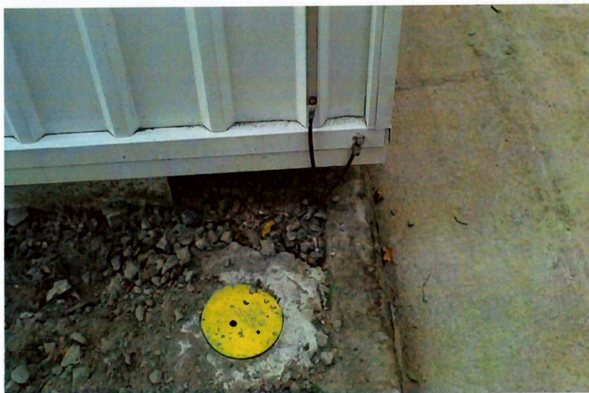
Foto 27. Detalhe da caixa de inspeção da haste de aterramento, da interligação do ponto de aterramento do contêiner e aterramento do barramento de descida do pára-raios. (cortesia A&M eng. Associados Ltda)
