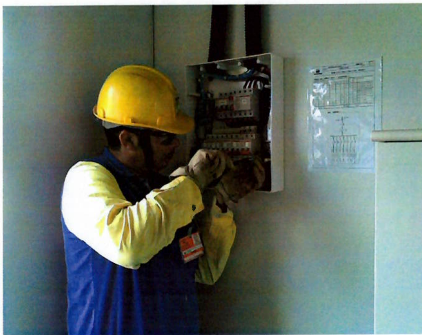
Foto 20. Fixação do quadro de distribuição. (cortesia A&M eng. Associados Ltda)
