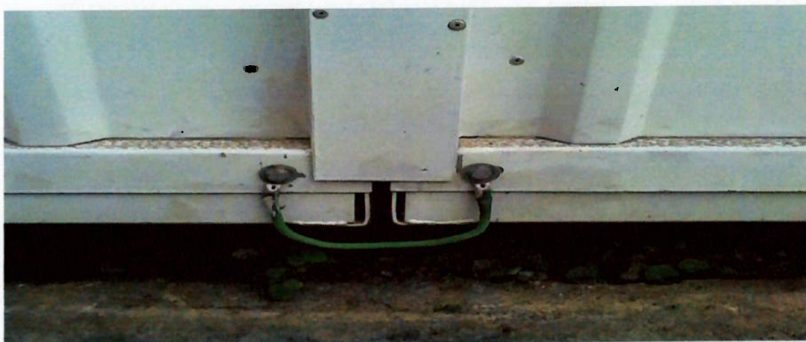
Foto 24. Detalhe da interligação das massas metálicas. (cortesia A&M eng. Associados Ltda)
