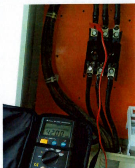
Foto 43. Verificação da continuidade dos circuitos e falha no isolamento. (cortesia A&M eng. Associados Ltda)
