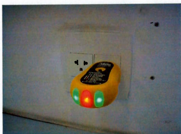
Foto 40. Verificação da presença de tensão, identificação de disjuntores e circuitos.
