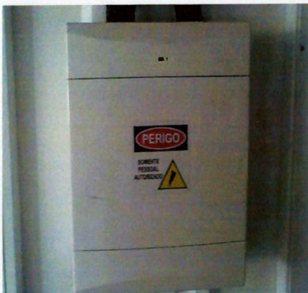
Foto 30. Detalhe da informação de PERIGO na tampa do quadro. (cortesia A&M eng. Associados Ltda)
