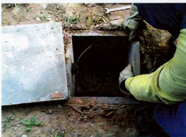
Foto 37. Detalhe da caixa de passagem da infra-estrutura lançamento de cabo alimentador. (cortesia A&M eng. Associados Ltda)
