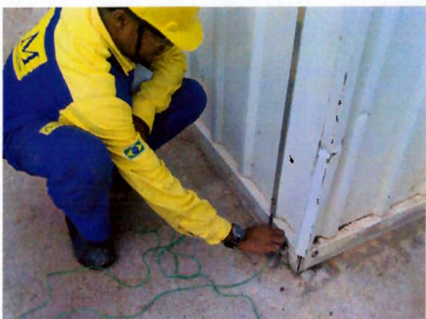
Foto 46. interligação do contêiner aterrado. (cortesia A&M eng. Associados Ltda)
