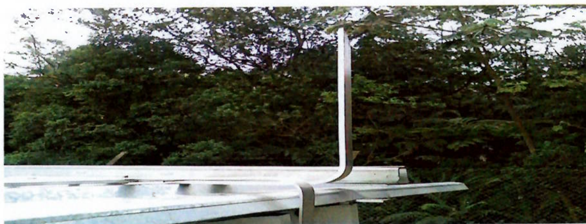
Foto 23. Detalhe do captor em barramento de alumínio. (cortesia A&M eng. Associados Ltda)
