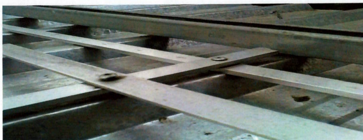
Foto 22. Barramento de alumínio utilizado como condutor. (cortesia A&M eng. Associados Ltda)
