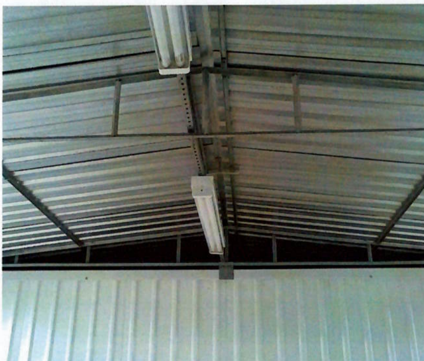
Foto 33. Detalhe da luminária do refeitório, com proteção contra gases e vapores. (cortesia A&M ENG. Associados Ltda)
