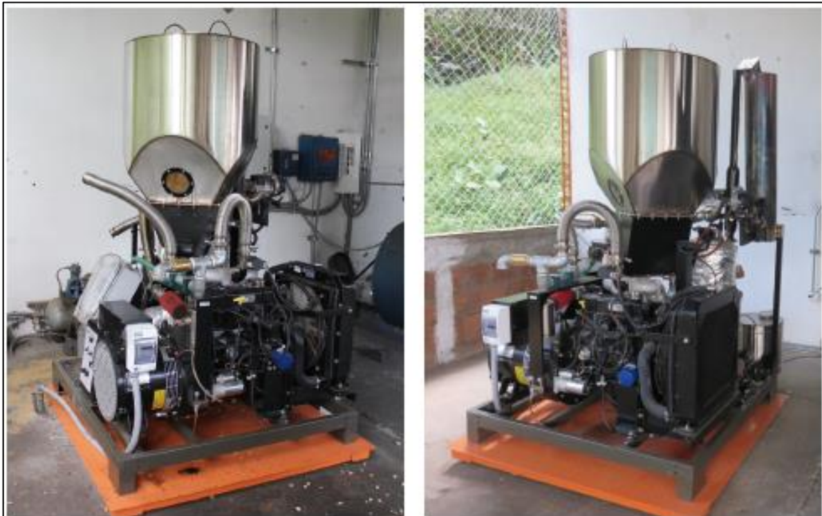
Figura 29. Unidad de generación eléctrica GEK 20 kWe (potencia real), a partir de astillas de madera.
