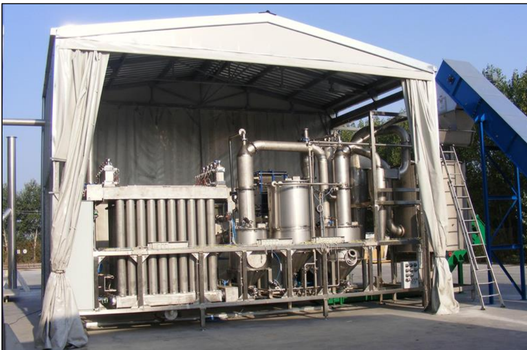
Figura 31. Gasificador de biomasa con unidad de generación eléctrica acoplada.
