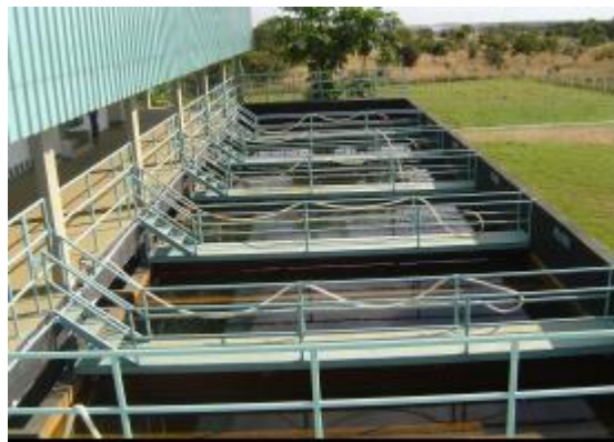
Vista geral das unidades de dupla filtração
