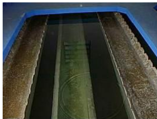
b) calhas separadas para coleta de água filtrada (abaixo) e de água de lavagem dos filtros (acima)
