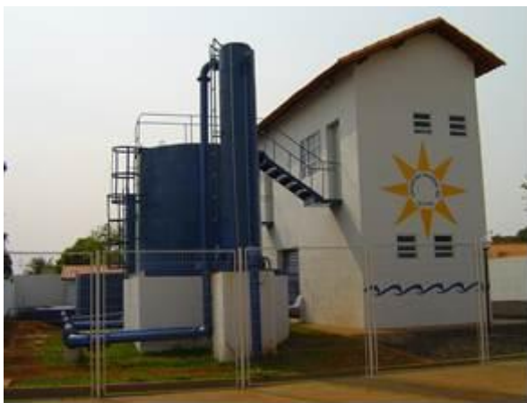
Vista geral da ETA
