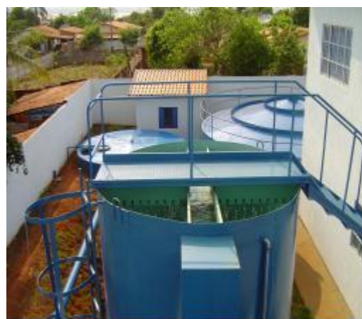
Filtro descendente, reservatório de água tratada (à direita) e tanque de recepção da água das lavagens dos filtros (à esquerda)
