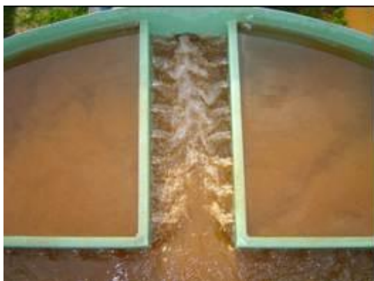
a) calha de coleta de água de lavagem e de água filtrada
