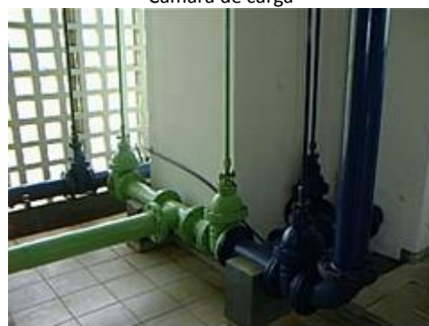
Tubulações e válvulas dos filtros
