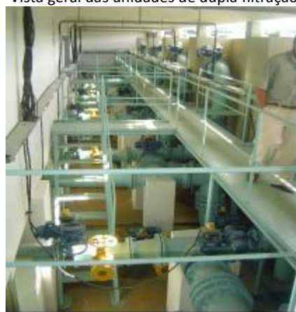
Tubulações e acessórios dos filtros
