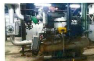
Chiller Antigo 200 TR | kW/TR 0,9
