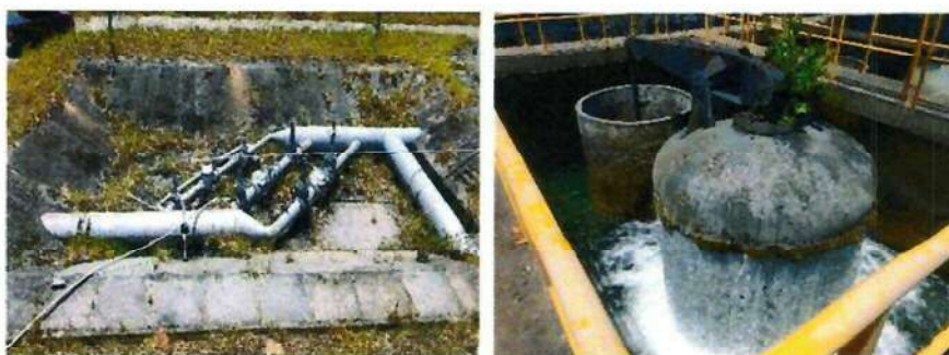
Figura 4.5.12 – Sistema de Caixa de Quebra Pressão da Deso, em Capela/SE Fonte – (Vitalux Ecoativa)
