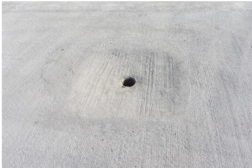
Figura 8.2 - Dispositivo de coleta de águas pluviais na superfície do pavimento. Fonte: Visita técnica (ago/2013)
