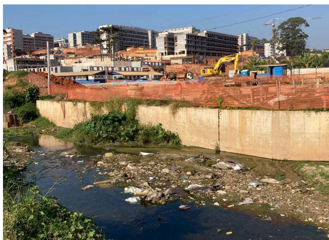
Figura 21 : Córrego cheio de entulhos ao lado da obra
