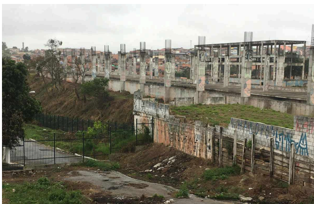
Figura 17 : Abandono da Obra e estação Varginha 2017
