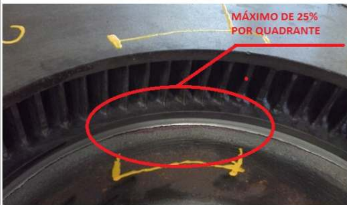
Figura 6A – detalhe do vazamento em parte de um quadrante
