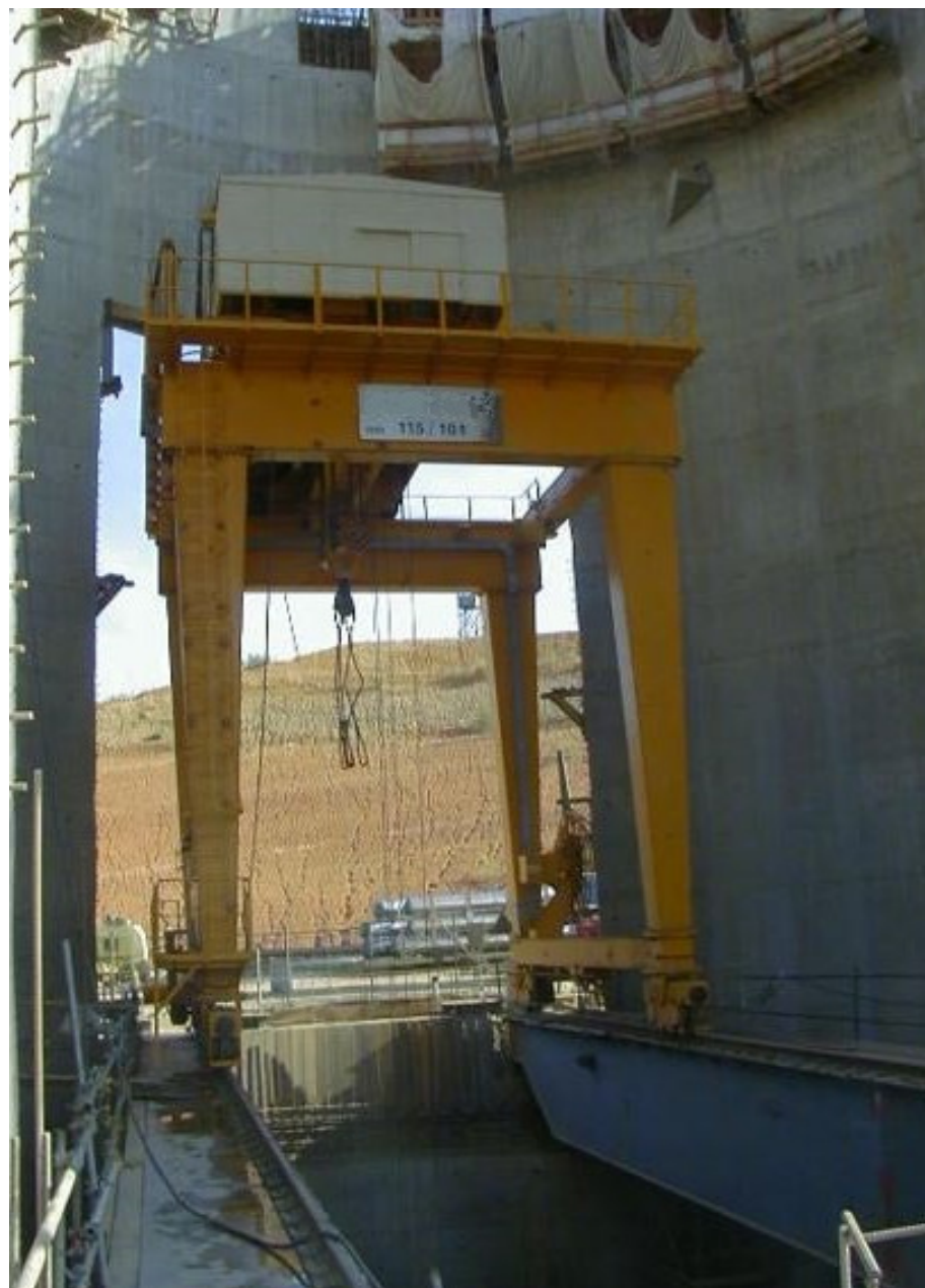
Figura 21 – Pórtico rolante da Casa de Força.
