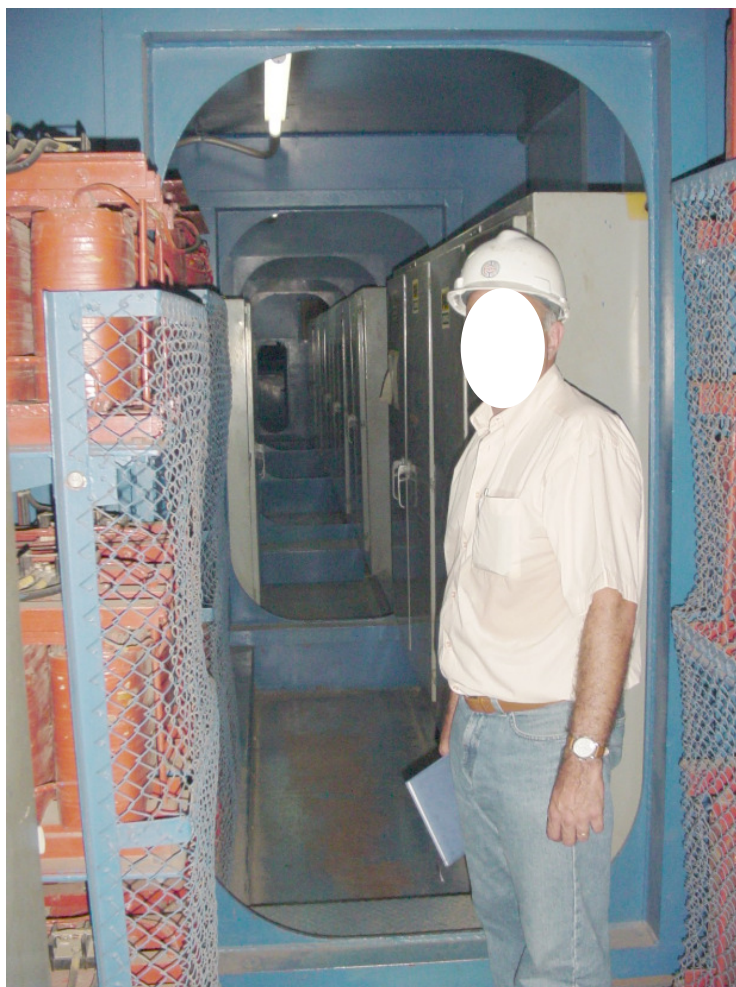
Figura 28 – Painéis elétricos enclausurados no interior da viga principal.
