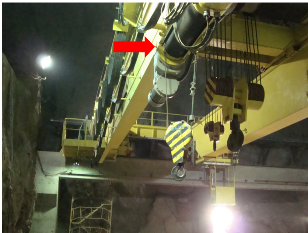
Figura 30 – Monovia com talha e alimentação elétrica sob a ponte rolante.
