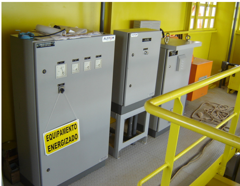
Figura 26 – Painéis elétricos na cobertura do pórtico.
