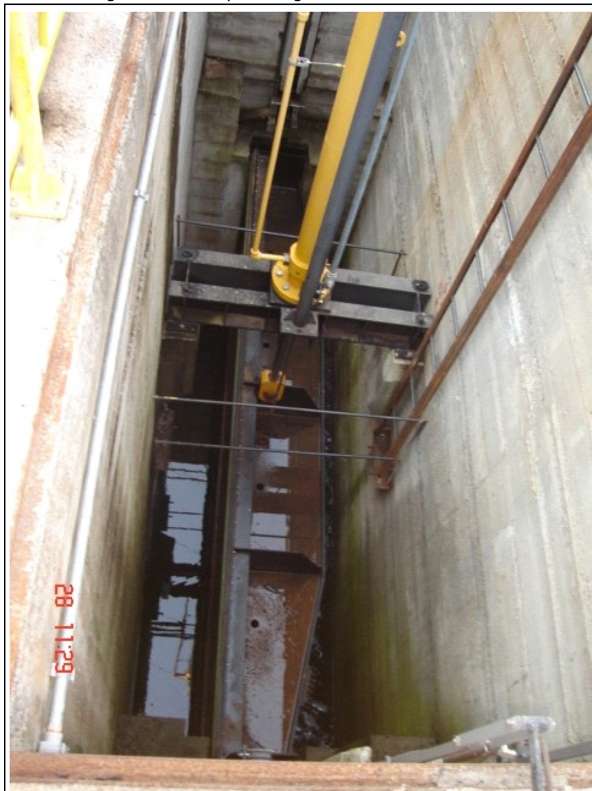
Figura 13 – Comporta vagão instalada em vão ativo.
