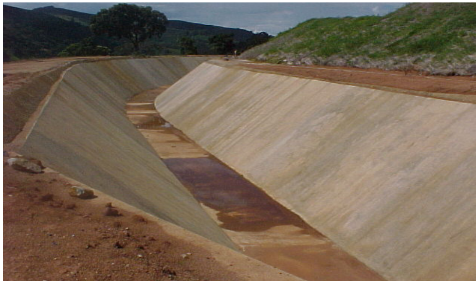
Figura 4 – Canal de adução.
