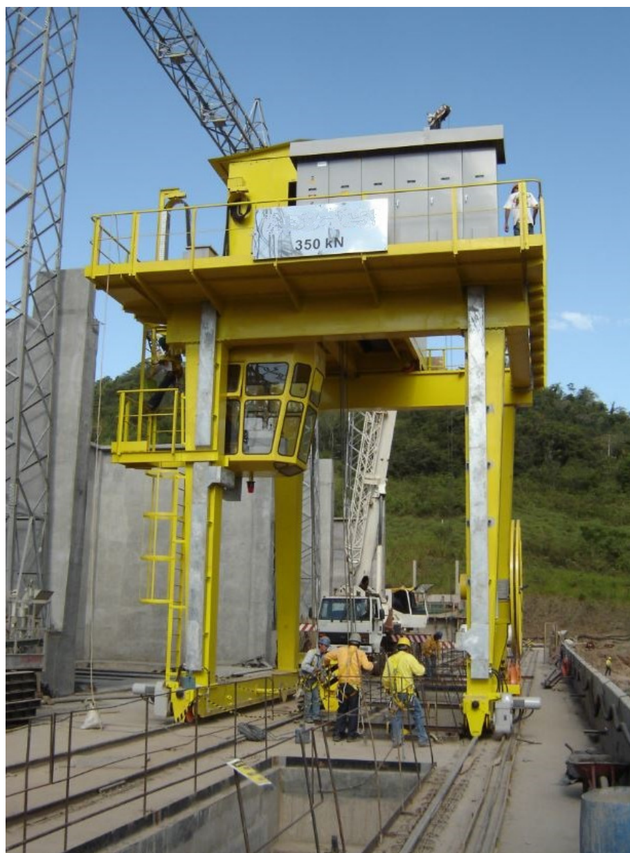
Figura 23 – Pórtico rolante do Tubo de Sucção.
