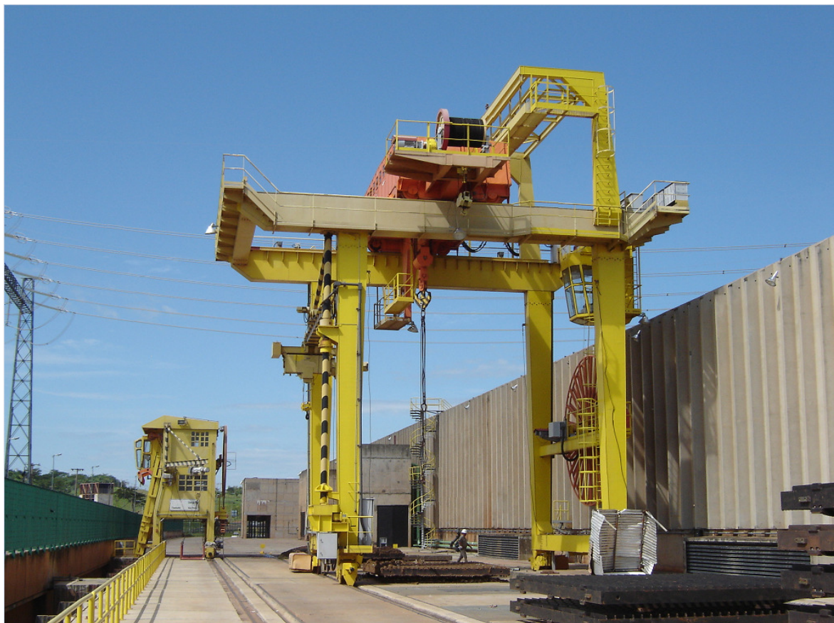
Figura 22 – Pórtico rolante da Tomada D'Água e Máquina Limpa-Grades.
