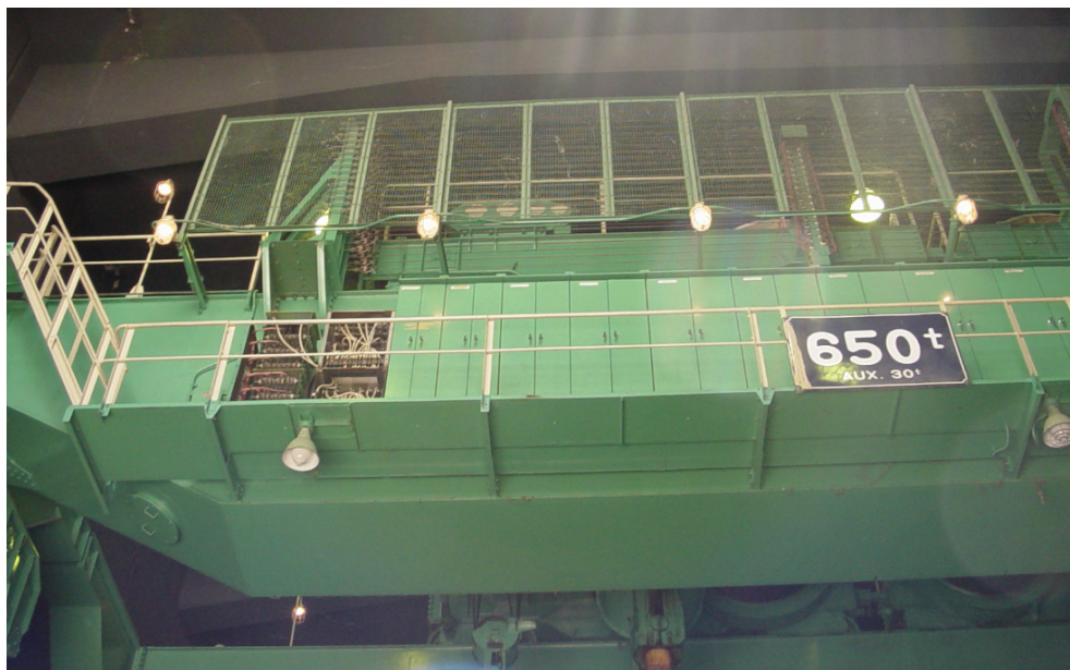
Figura 25 – Painéis elétricos na lateral da ponte.
