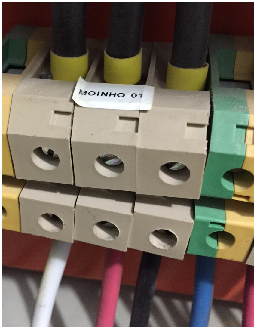
Figura 20 – Aterramento Carcaça Moinho
