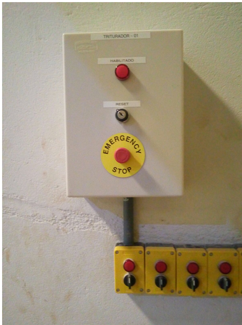
Figura 23 – Quadro relé de segurança
