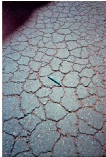
Figura 20 - exemplo de trincas couro de jacaré
