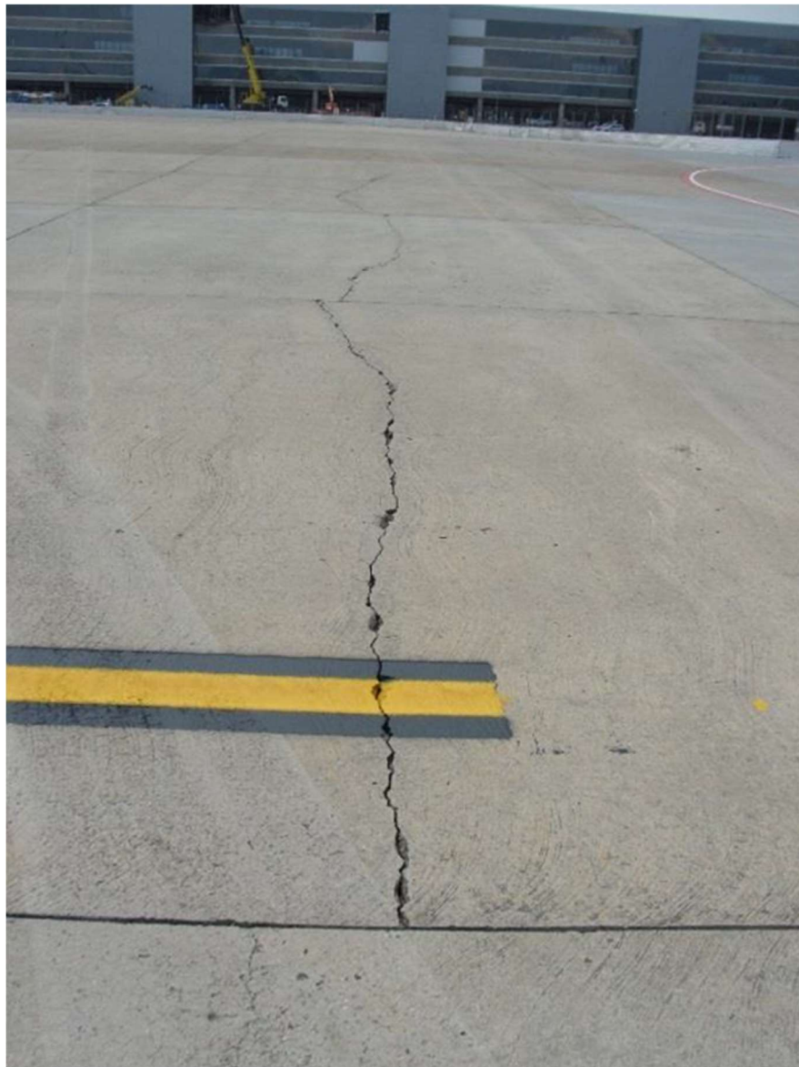
Figura 21 - Exemplo de fissura transversal
