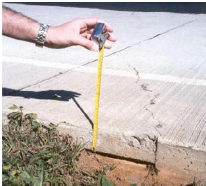
Figura 23 - Exemplo de uma fissura de canto
